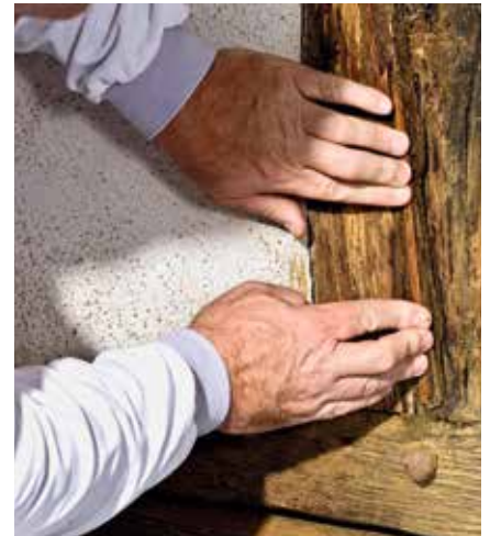
Schritt 3: Nur bei Rissen mit einer Breite > 10 mm wird ein passender trockener Holzkeil eingedrückt.
