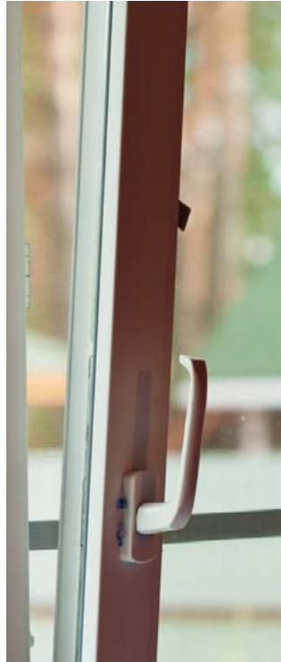
Lüftung durch Kippstellung
