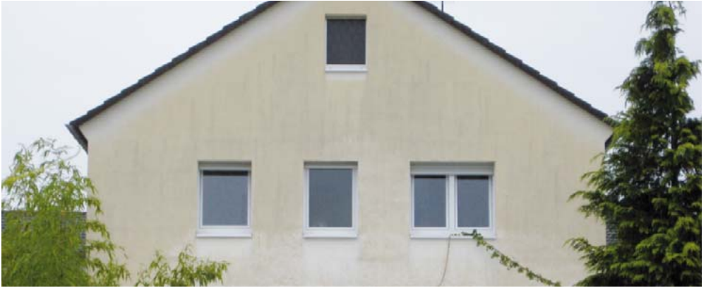
Der Verzicht auf eine wasserabweisende Fassadenbeschichtung kann ursächlich für Schimmel im Innenbereich sein.
