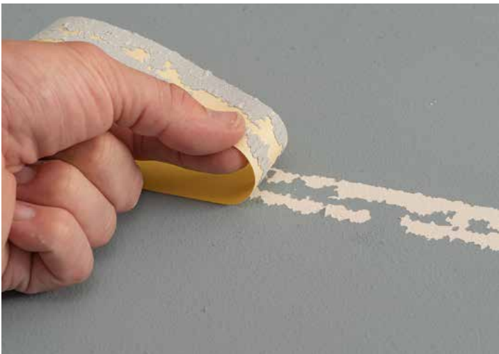
Häufiges Problem: Ablösungen auf Gipsspachtelmasse.
