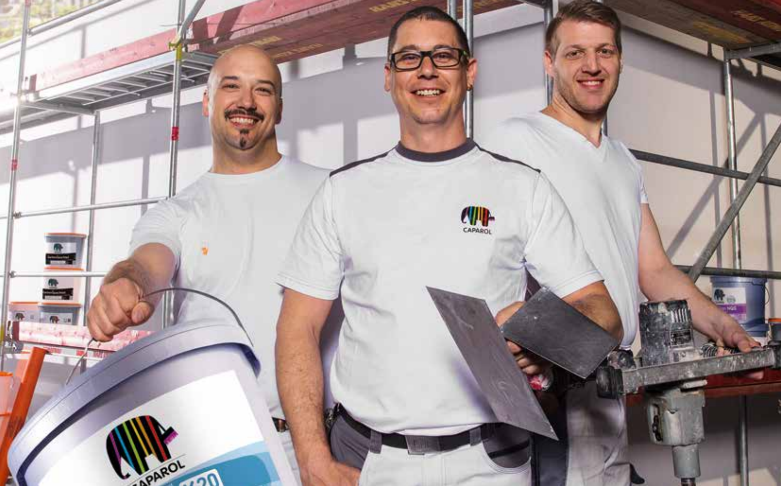
Caparol Techniker Angelo Dreier, Dennis Heinrich und Jan Brotrück im Einsatz an der Baustelle
